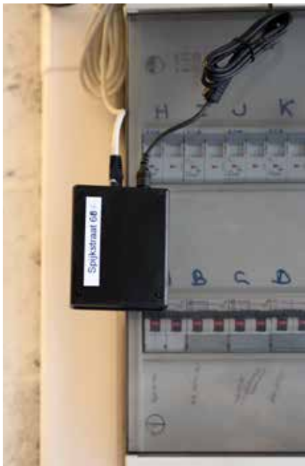
De mini-computer die de batterijen en zonnepanelen aanstuurt
