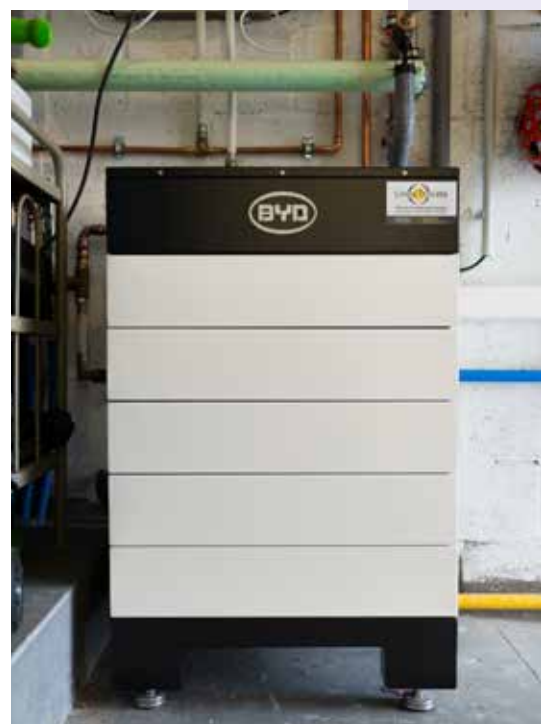
Eén van de batterijen die geïnstalleerd werden bij de deelnemers van het cVPP-project.
